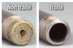
Tuyauterie d'eau chaude
