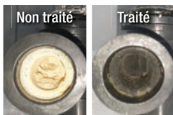
Sortie du chauffe-eau
